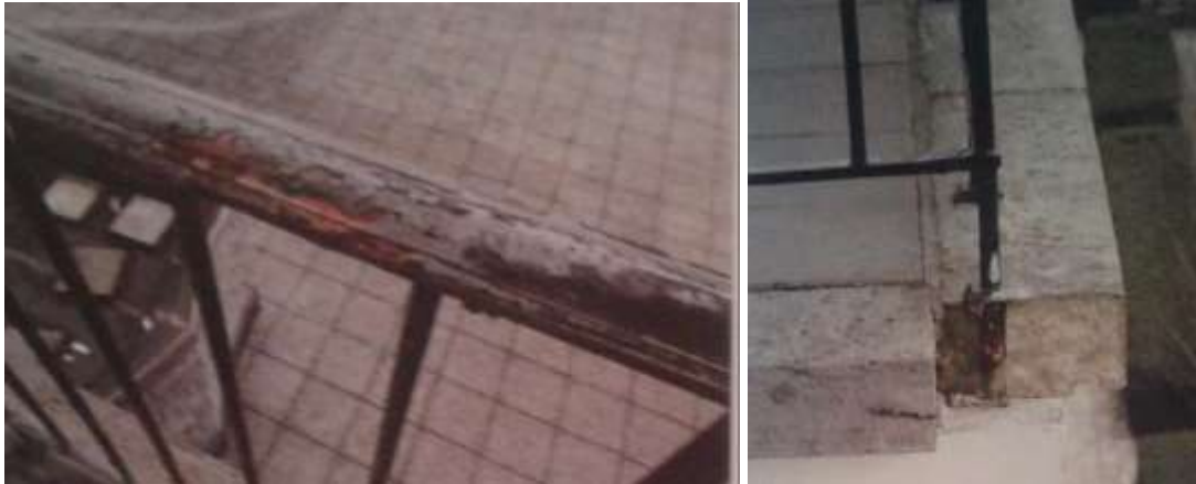
A gauche : garde-corps existant fortement corrodé. Image tirée du dossier.
