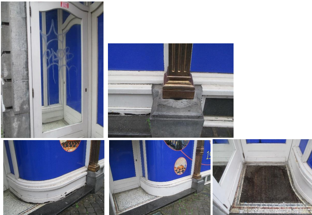
Pathologies constatées in situ mais non traitées dans le cadre de la demande © Urban.brussels
