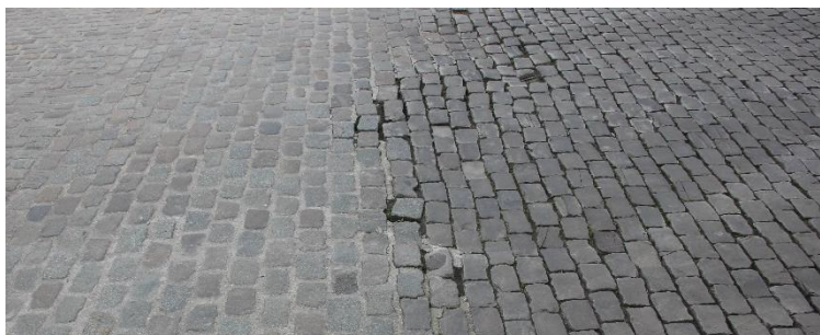
Figure 77 : quartier du Grand Hospice, surface récemment repavée vs. pavage endommagé
