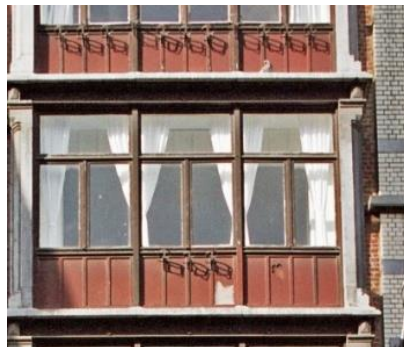
Remise en couleur de l'oriel avec sa teinte d'origine. Image Google Street View© 2022 et 2009
