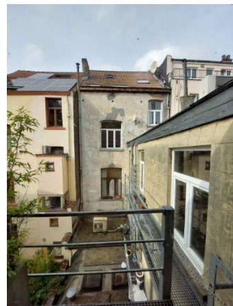
Châssis hétéroclites en façade arrière (Photo extraite du dossier de demande)
