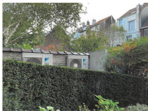
Groupes de pompes à chaleur implantés dans le jardin, sur le mur mitoyen de la maison d'A. Pompe (photo extraite du dossier).
